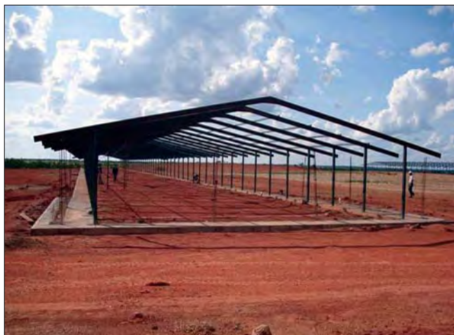
Figura 5. Vista de uno de los galpones de la Granja de Reproductoras pesadas del INIA en construcción en el Municipio Pedro María Freites de estado Anzoátegui.
