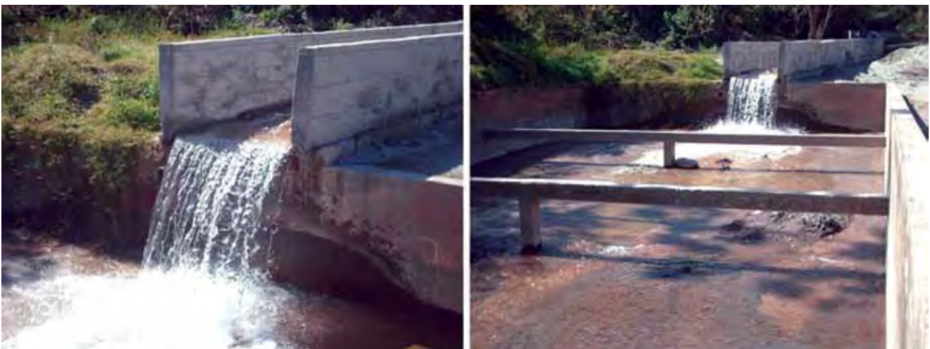
Foto 2. Desarenador del Campo Experimental Truchícola de Boconó.
