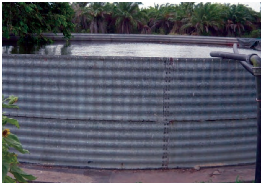
Foto 2. Tanque australiano 250.000 litros de agua.
